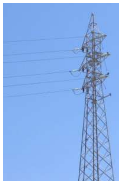
Figura 8 Estructuras o apoyos de fin o inicio de línea
